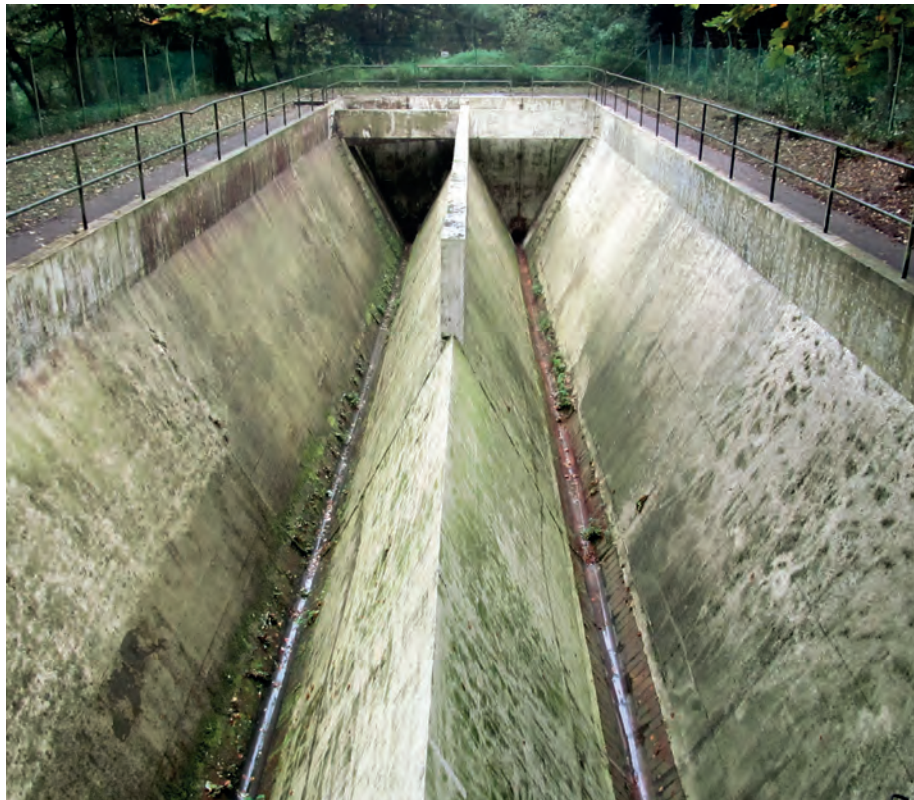
Offenes, sanierungsbedürftiges Regenüberlaufbecken
