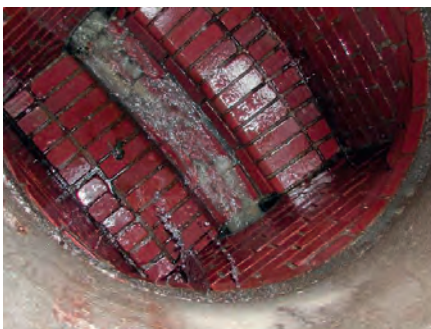
Schachtbauwerk vor der Sanierung...
