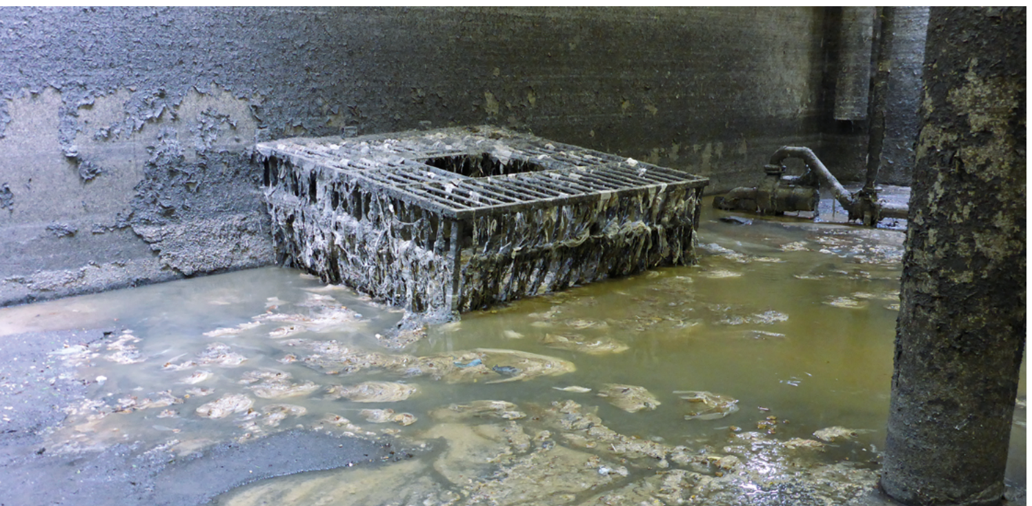
Bestandsbecken mit Absetzbereichen
