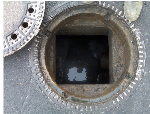
Betondecke mit Öffnung 50 x 50 unter Schachtdeckel; kein Gerinne vorhanden
